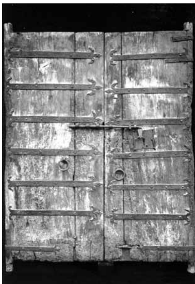
FIG. 6. Particolare del portone del Tempietto: lato visto dal chiostro del monastero di Santa Maria in Valle prima dell'intervento di restauro.
