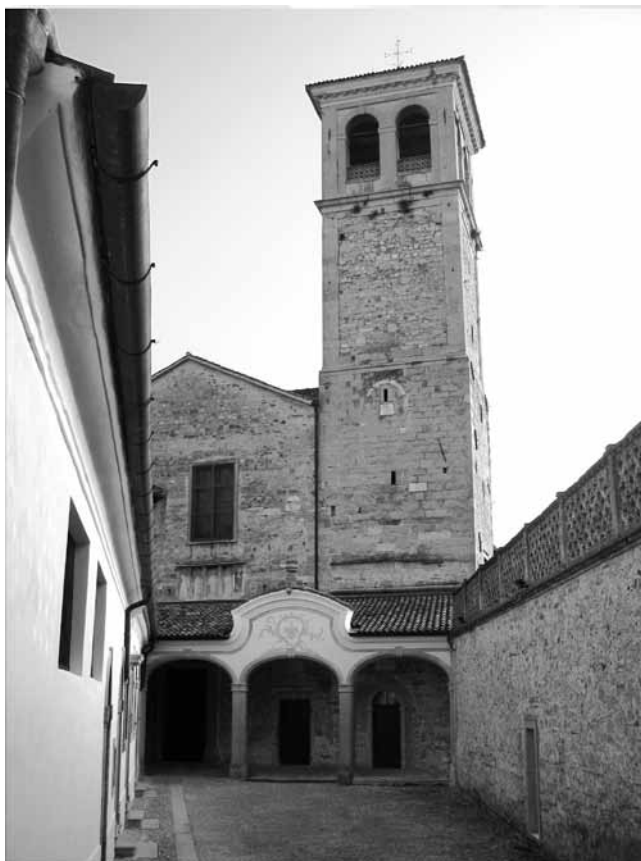
FIG. 4. Facciata del San Giovanni dopo le fasi di rimozione dello strato di intonaco.
