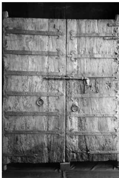
FIG. 7. Particolare del portone del Tempietto: lato visto dal chiostro del monastero di Santa Maria in Valle dopo l'intervento di restauro.
